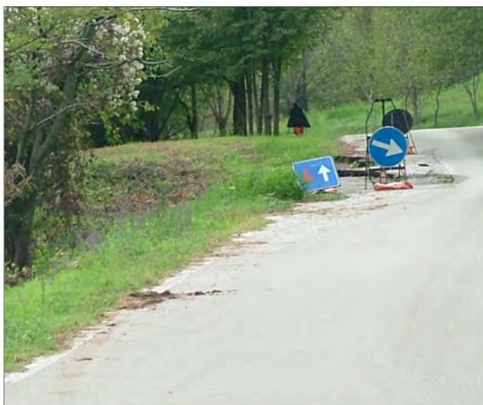
Frana lungo via Capitello in loc. Pugnello
