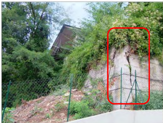
Muro perimetrale lesionato per frana in via Cesare Baldo
